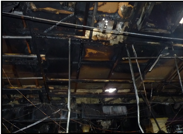
Un plafond sans exutoire constitué de multiples couches de matériaux.
